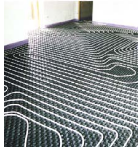
Tubazioni pannelli radianti
